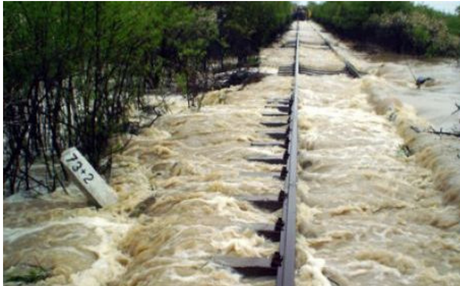
Figura 1.6. Cale ferată afectată de inundații
